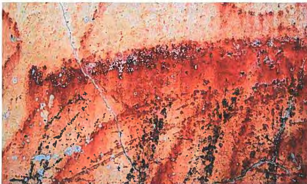
Foto 15: Paño A, zona de aparición de florescencias de sales hidrosolubles. Estas han cristalizado rompiendo el material del enlucido y de las pinturas, provocando pequeñas pérdidas
