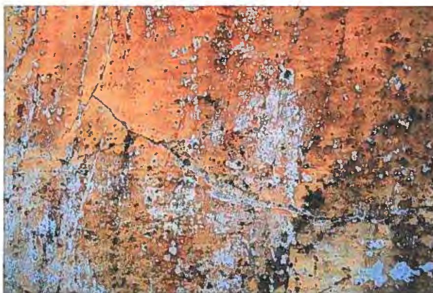
Foto 16: Paño A, detalle de eflorescencias de sales hidrosolubles
