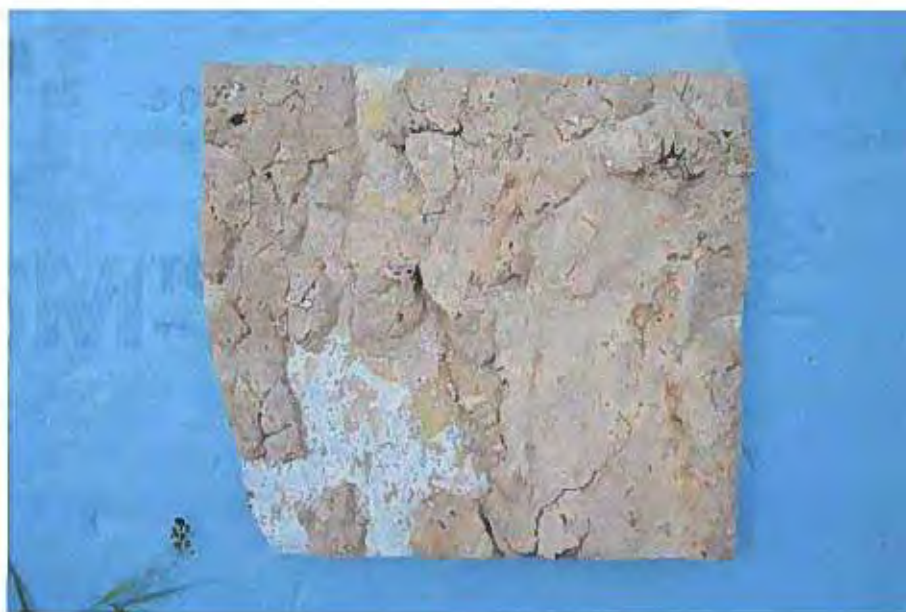
Foto 36: Pieza de prueba arrancada, se observa la zona inferior izquierda, en color blanco, donde se produjo un strappo, esto es, el enlucido con las pinturas se quedó adherido a la gasa, separándose del mortero
