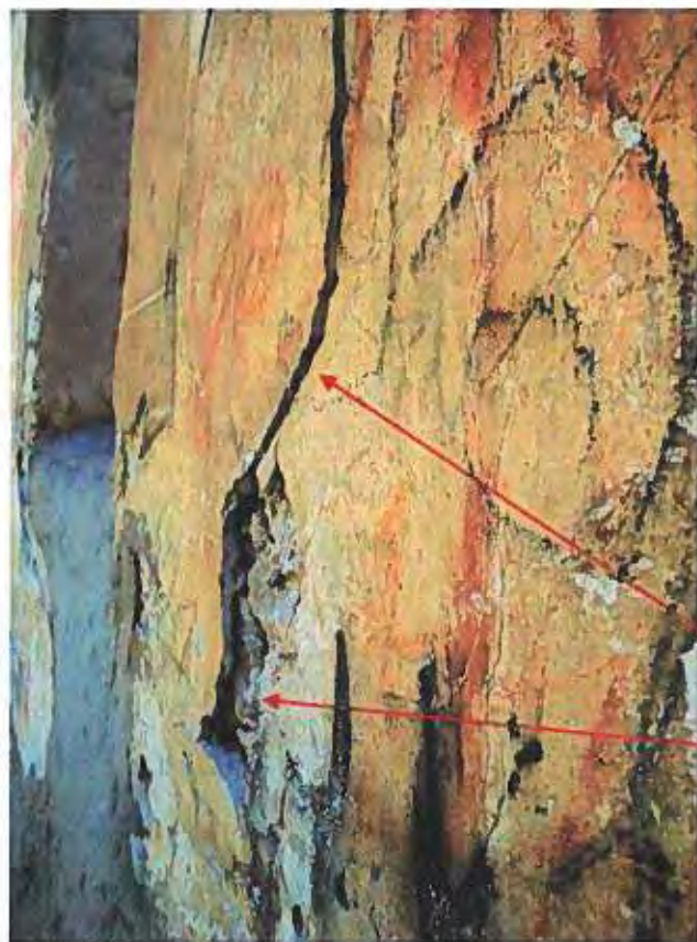
Foto 12: Pared C, foto de perfil donde se aprecia la deformación del muro, grieta con escalón, pérdida del mortero y oquedades
