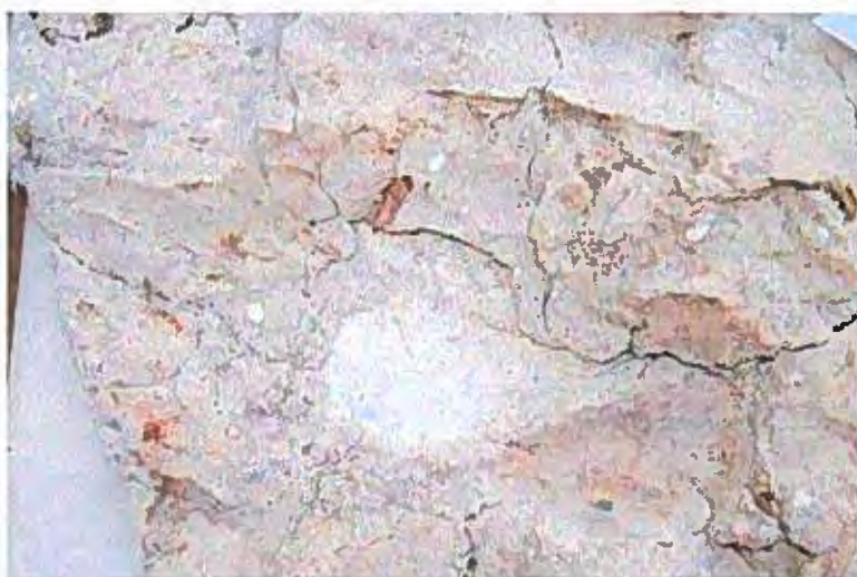
Foto 57: Rotura del mortero produciendo un strappo durante el arranque, (se observa la parte blanca correspondiente al enlucido adherido a la tela)
