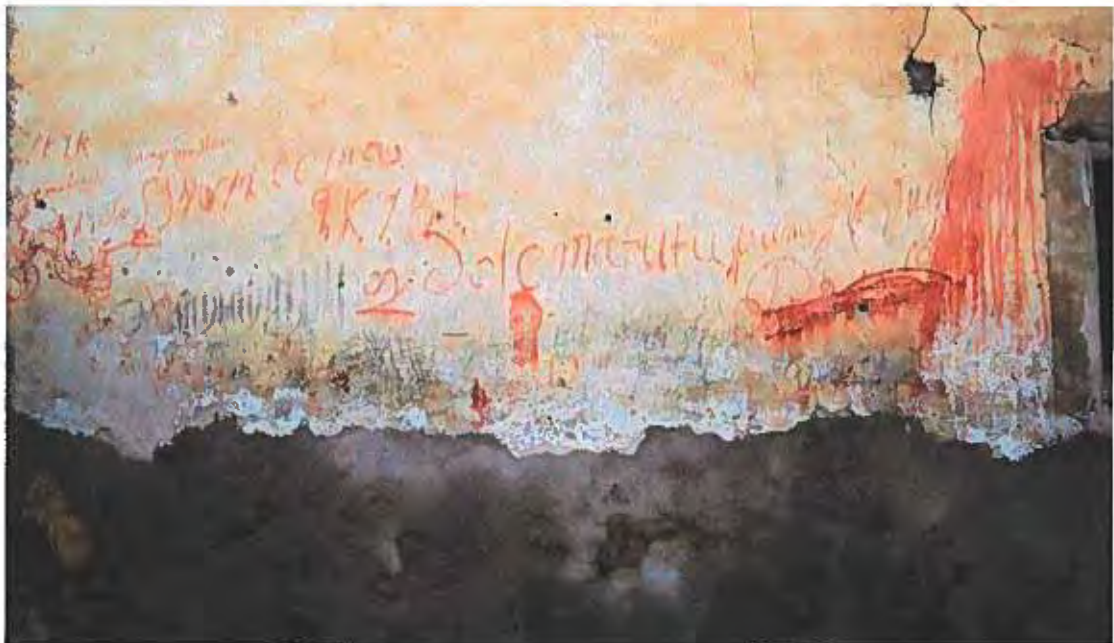
Foto 9: Pared A, El cemento aplicado en la parte inferior tiene un color oscuro por la humedad que adquiere por capilaridad y que transmite al mortero original provocando arenizaciones, sales y daños irreversibles en las pinturas cercanas
