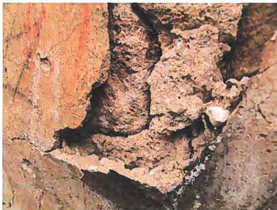
Foto 11: Paño C, otro detalle de los daños producidos por arenización del mortero
