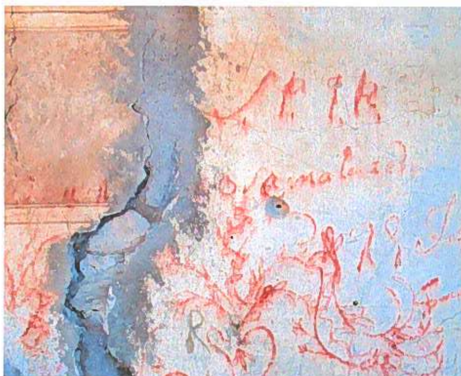
Foto 17: Paño A, Una vez eliminado el cemento de las grietas y agujeros se observó que también invadía la superficie de dibujos e incisiones
